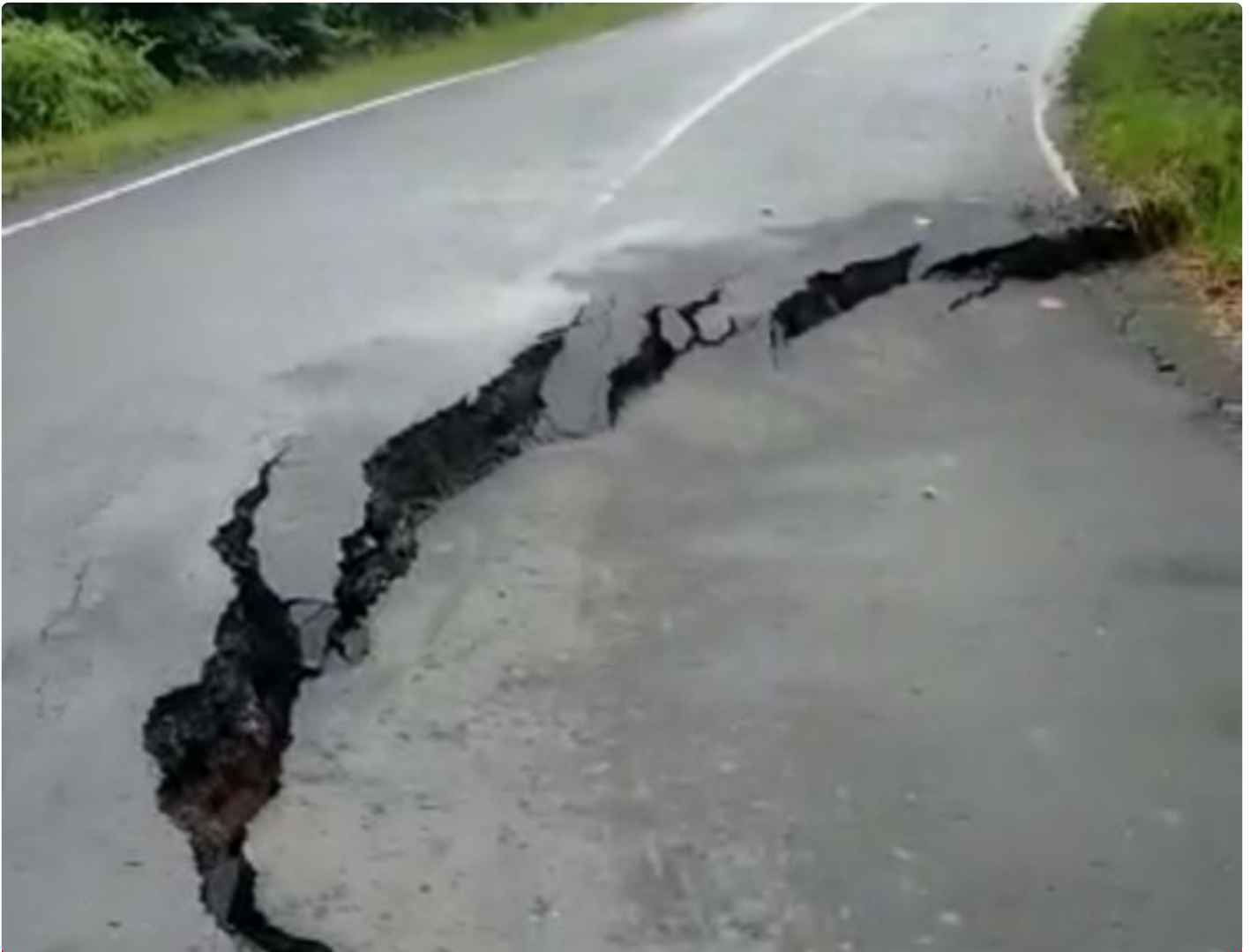
Gambar: Kondisi Ruas Jalan Nasional Kuala Kurun - Sei Hanyo Yang Mau Longsor
